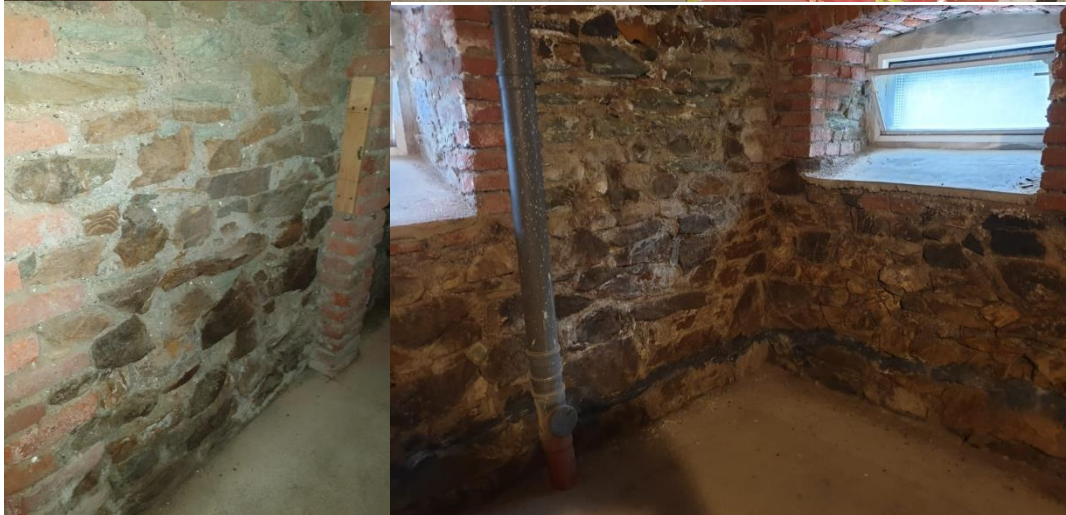
Erste sichtbare Abtrocknungen und Aussalzungen und nach unten absackender Feuchte schon nach wenigen Wochen Wirkzeit
